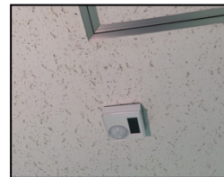
天井設置画像（人感センサー）
